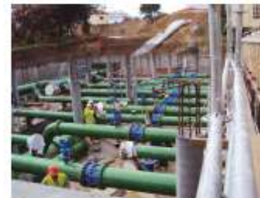
Estação Elevatória dos Olivais
