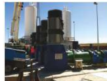
Estação Elevatória Pisão - Beja
