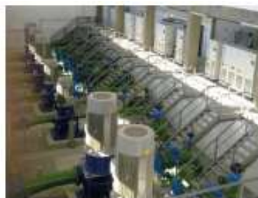
Estação Elevatória da Laje
