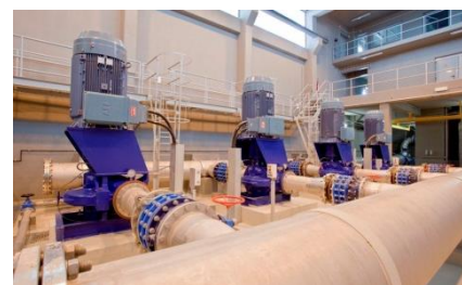
Estação Elevatória (Alcanhões, Santarém)
