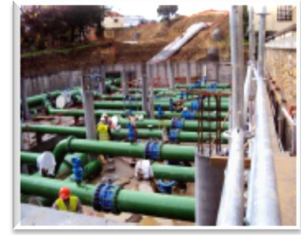
Estação Elevatória dos Olivais
