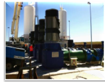
Estação Elevatória Pisão - Beja
