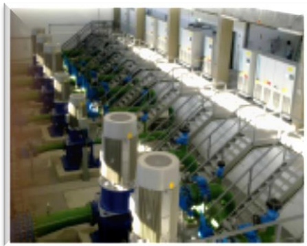
Estação Elevatória da Laje
