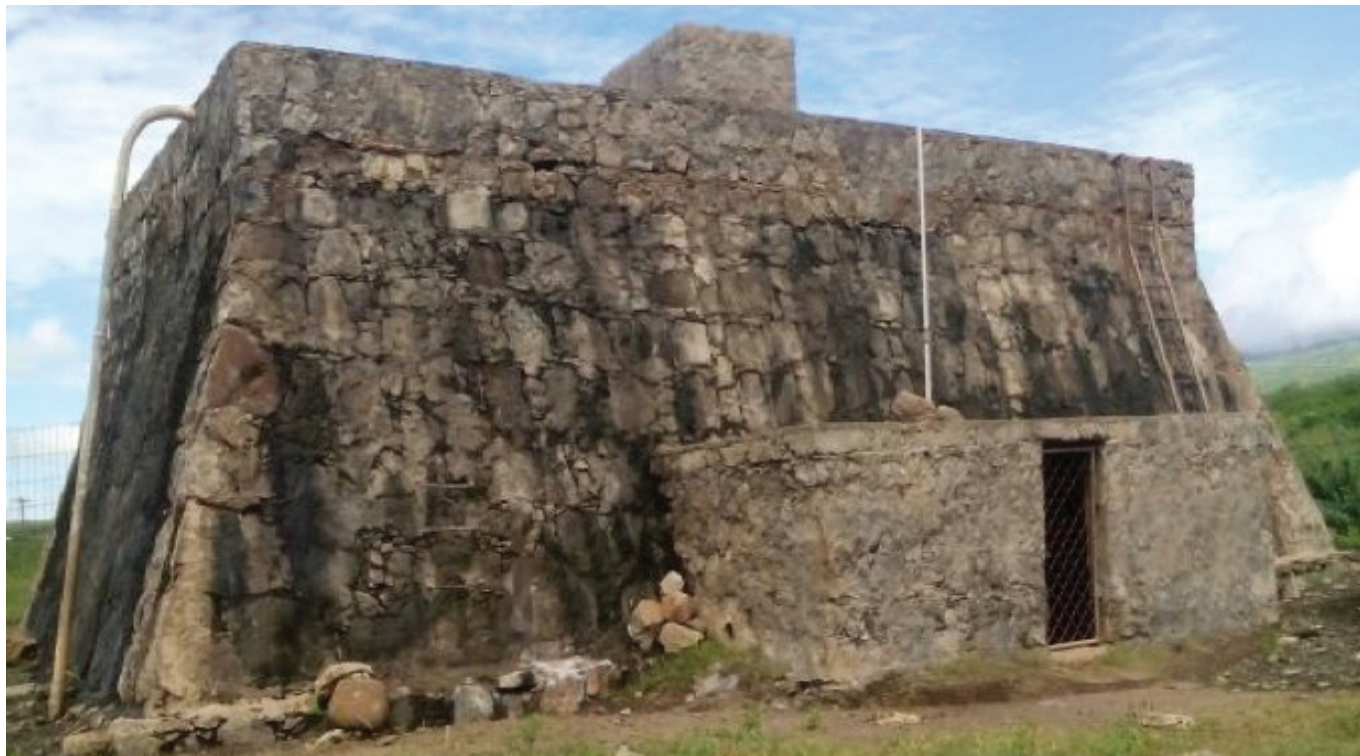
FIGURA 35 – ELECTRA SARL, RESERVATÓRIO DE ARMAZENAMENTO DE ÁGUA DE JOÃO VARELA
