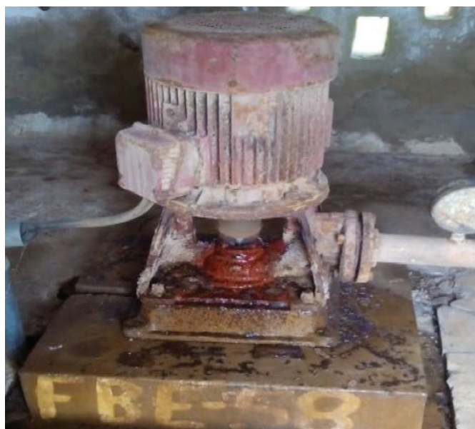
FIGURA 36 – ELECTRA SARL, BOMBA DE CAPTAÇÃO DO FURO FBE – 58
