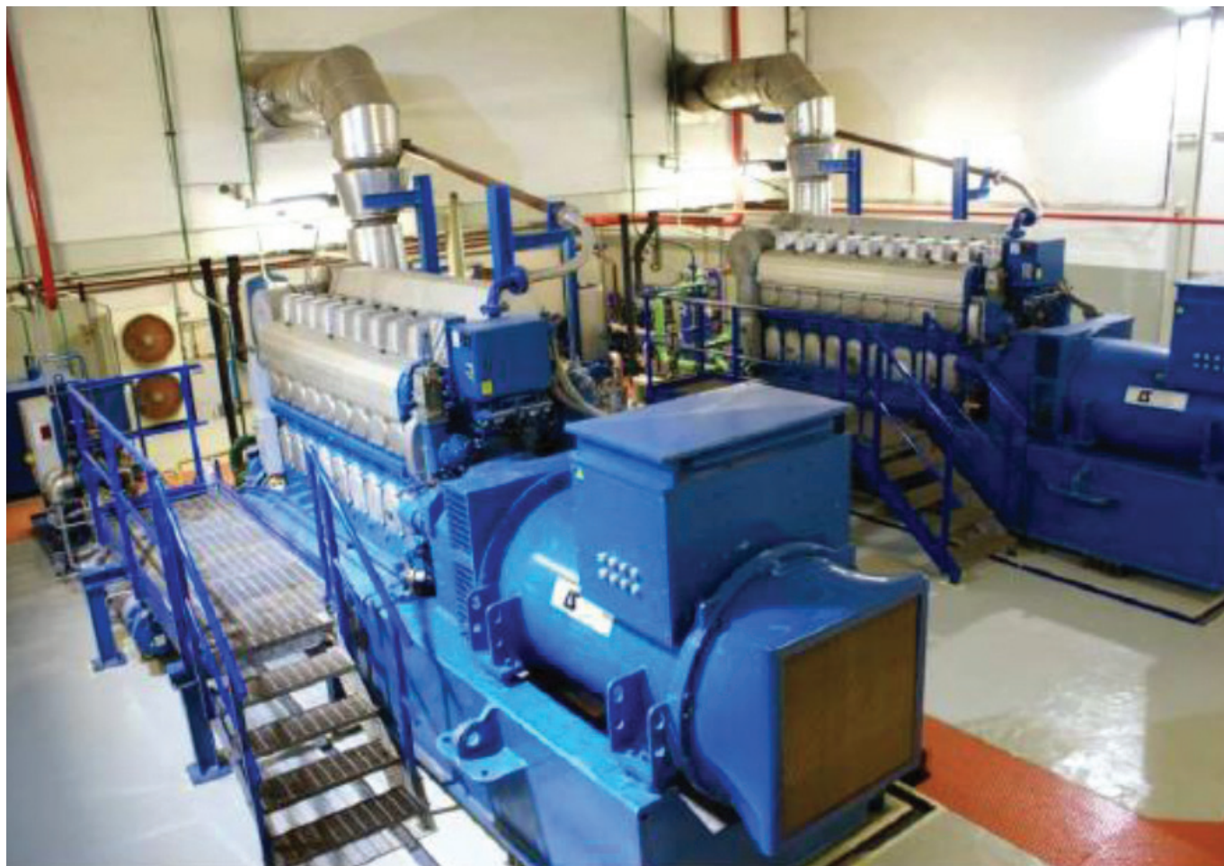
FIGURA 51 – APP, CENTRAL ELÉCTRICA DA APP (5MW)
