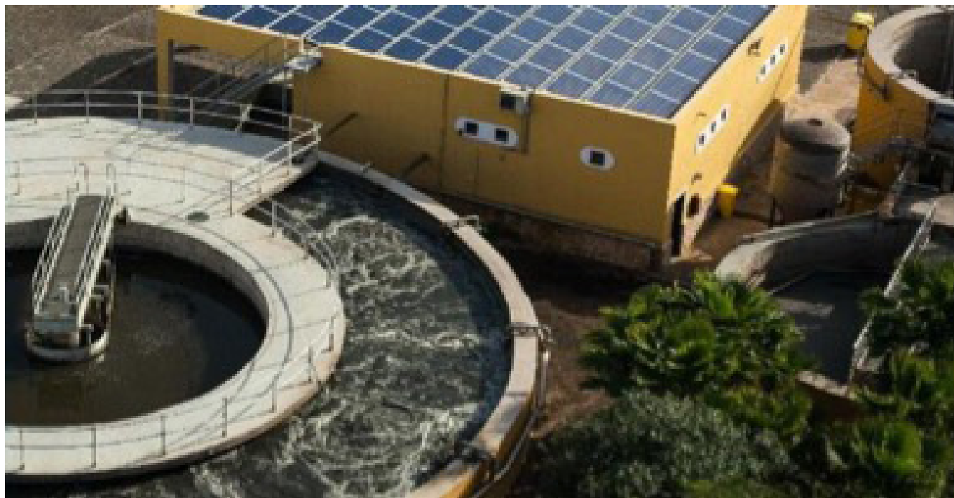
FIGURA 49 – APP, ETAR ALIMENTADO PELA INSTALAÇÃO SOLAR FOTOVOLTAICA DE 20MW
