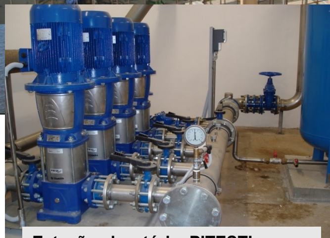
Estação elevatória PITESTI Roménia
