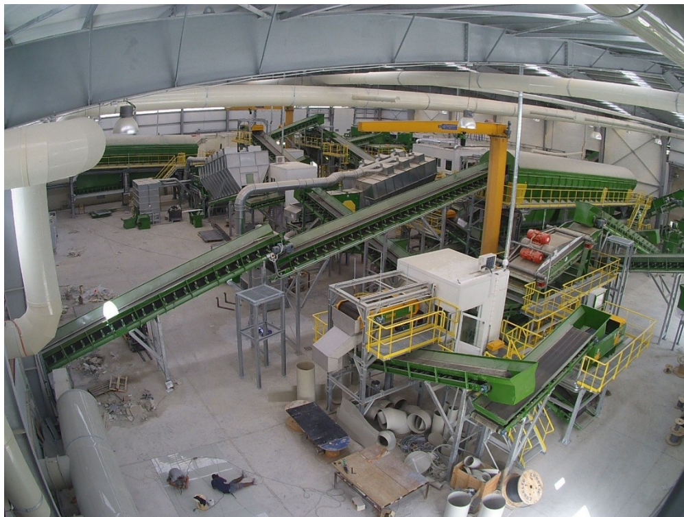
Central de Valorização Orgânica Malta 150 000 ton/ano residuos sólidos urbanos
