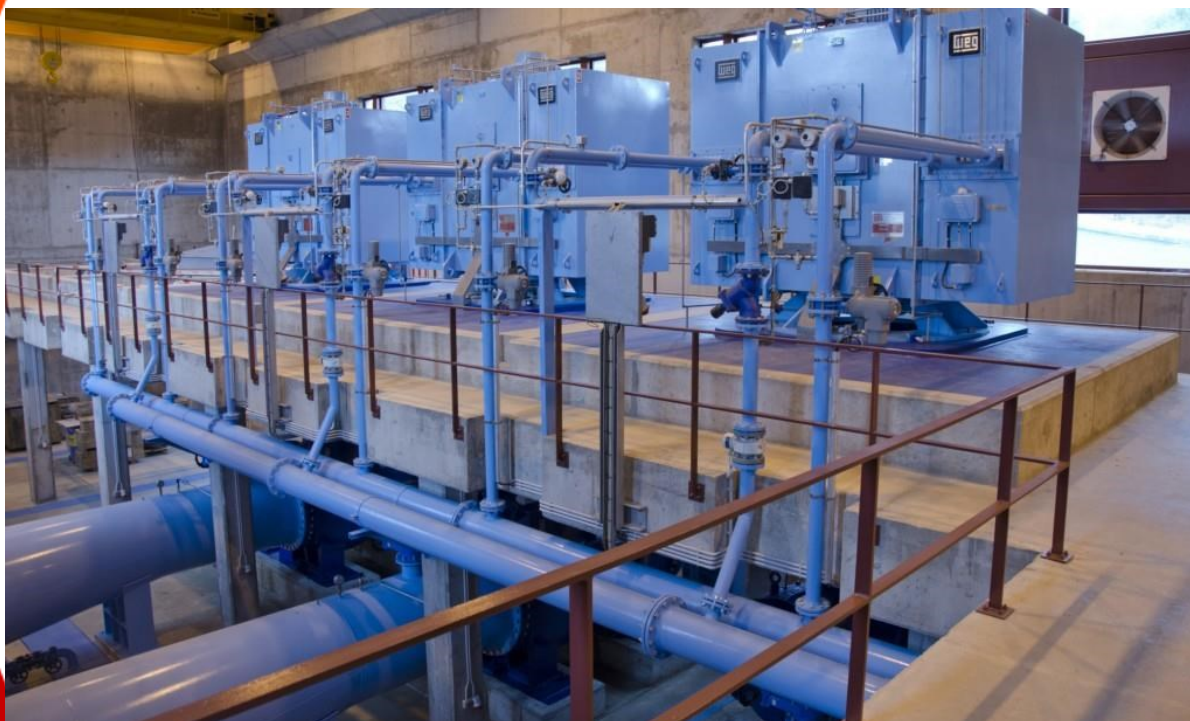
Estação Elevatória do Pedrogão – Alqueva 20m 3 /s 18MVA instalados
